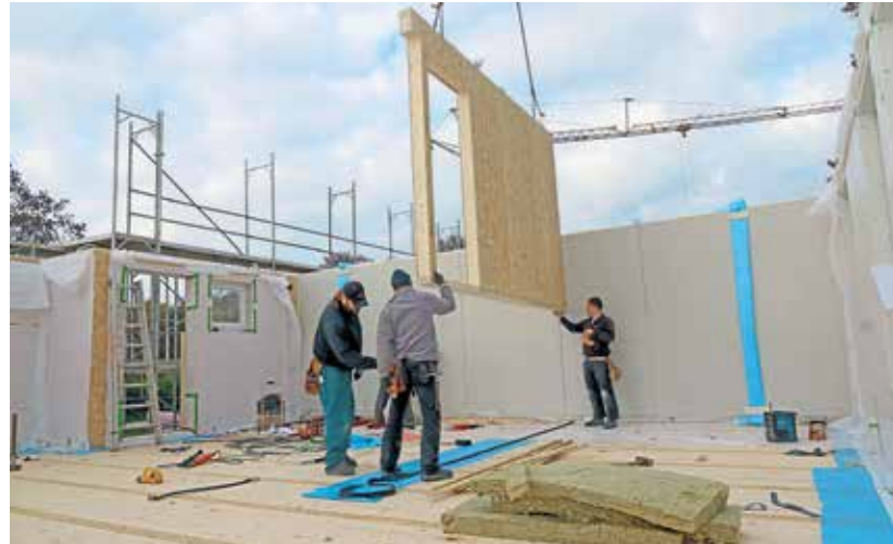
Die Außenhülle eines Holzfertigbaus steht binnen weniger Wochen. Wetterrisiken gibt es praktisch keine.
